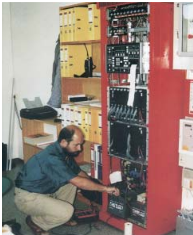
Nur funktionierende Brandschutzeinrichtungen machen Sinn – wiederkehrende Revisionen sind sinnvoll und notwendig
