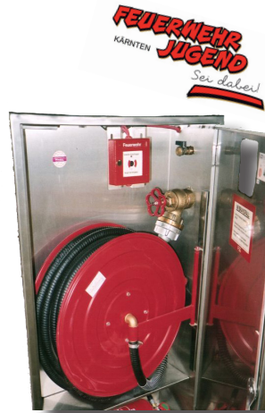
WANDHYDRANT Wasser Löschwirkung: kühlend
